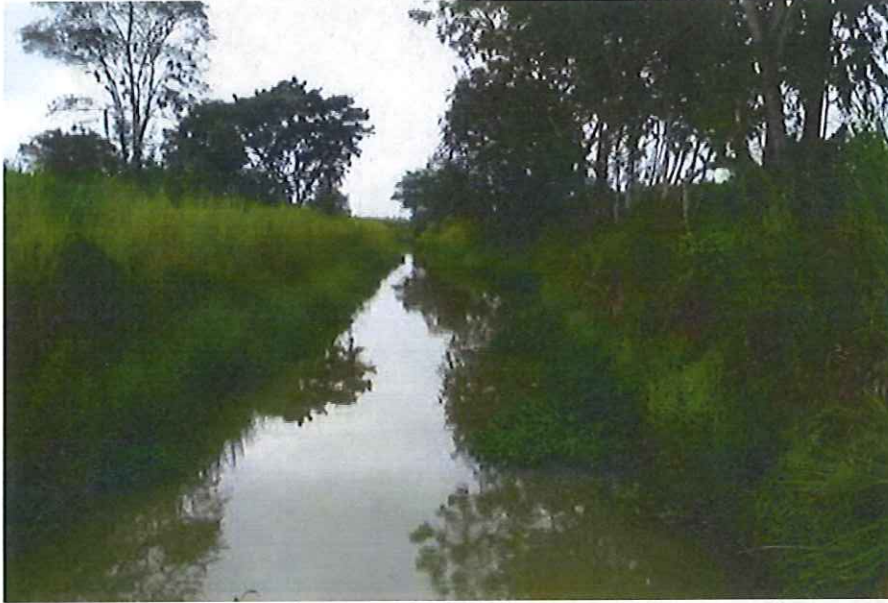
Fotografía 5: Conducción principal de tierra Calaguro - Santa Rosa del Gobierno Autónomo Descentralizado Provincial de El Oro, en el cantón Santa Rosa.
