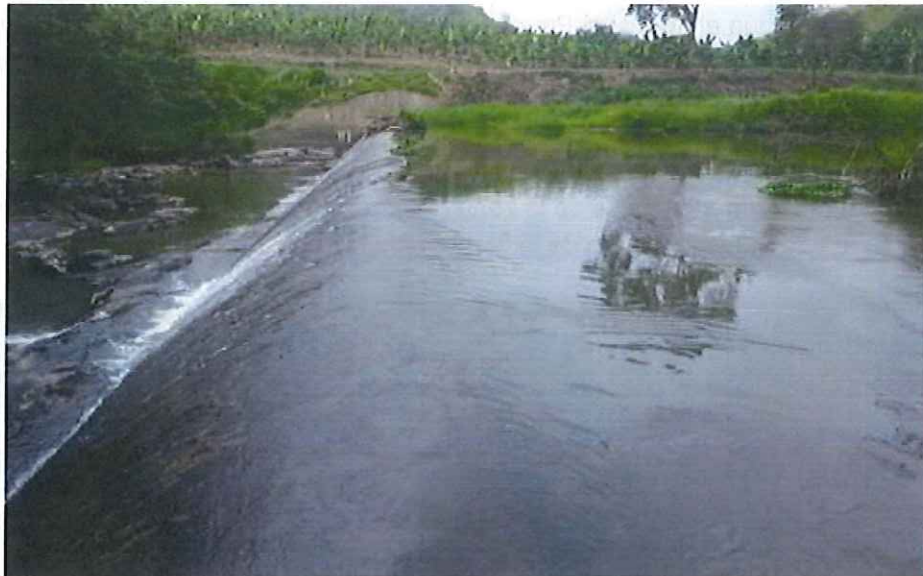
Fotografía 2: Obra de captación que consiste en un azud construido en el Río Arenillas, (aguas arriba existe un embalse de agua), para el ingreso del recurso hídrico a través de un par de compuertas que sirven para la regulación del caudal de ingreso del agua hacia el sistema de riego.
