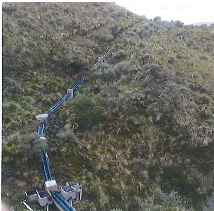
Fotografía 7: Conducción mediante tubería del Sistema de Riego Presurizado Atapo Palmira del Cantón Guamote.
