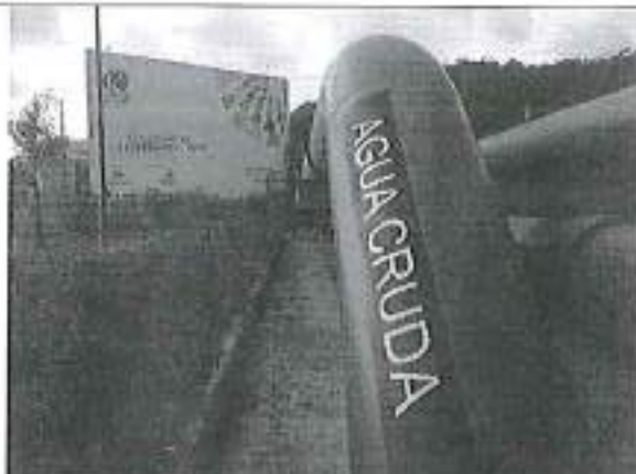
Fotografía 6. Sistema de conducción
