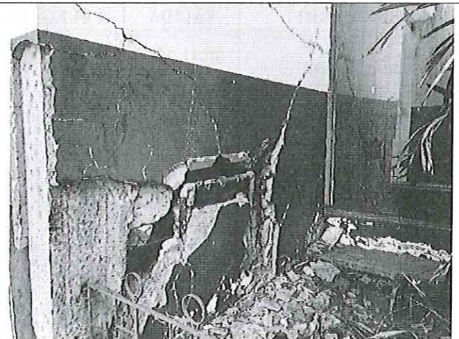
Fotografía 13. Inspección oficina Portoviejo – Daño estructural
