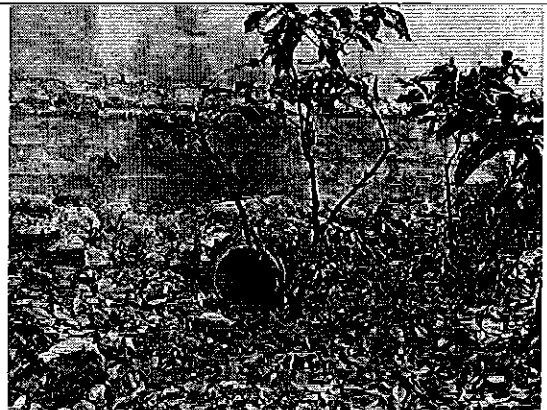
Fotografía 2. Tubería de la presunta afectación
