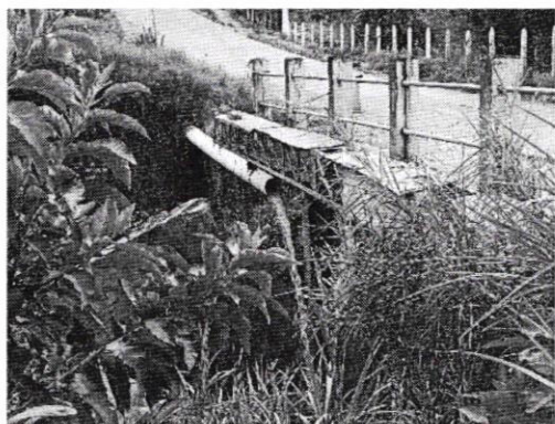
Fotografía 5. Descarga de aguas residuales
