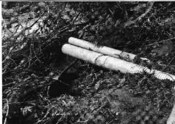
Punto N°14 : Punto de descarga al río Wiswayne desde la planta de tratamiento del sector campamento de controlistas
