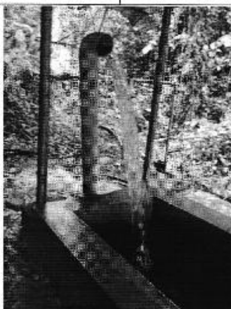
Punto N°7: Captación del pozo para agua de consumo humano
