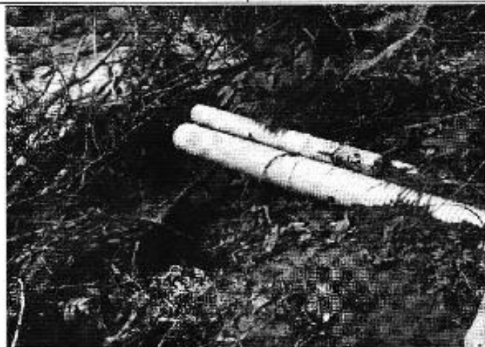
Punto N° 14 : Punto de descarga al río Wawayme desde la planta de tratamiento del sector campamento de contratistas
