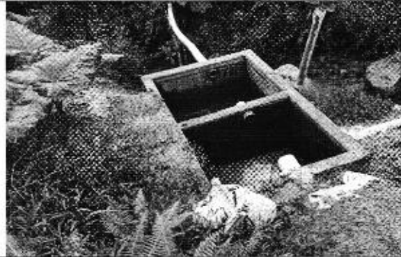
Tanque previo a la descarga
