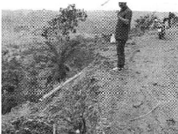
Figura 1: Destrucción de la tubería de conducción de la captación del Sitio Facundo - Flavio Alfaro
