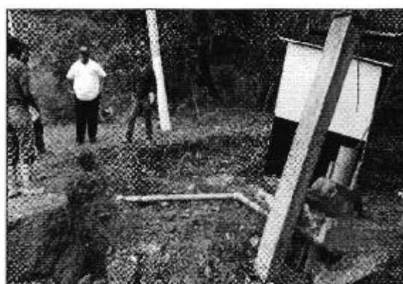
Figura 4: Pozo de captación destruido por terremoto - Jama
