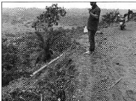
Figura 1: Destrucción de la tubería de conducción de la captación del Sitio Facundo - Flavio Alfaro
