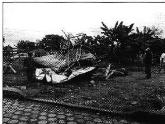
Figura 2: Tanque elevado colapsado por terremoto en el Barrio 4 de diciembre - El Carmen
