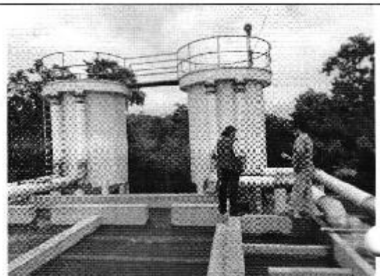
Ilustración 8. Planta de agua de AGUAPAS EP
