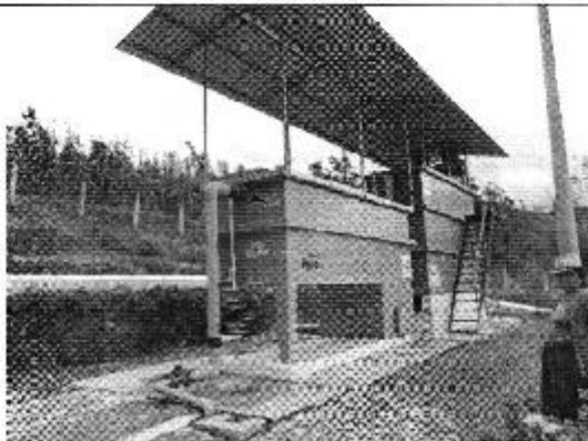
Ilustración 5. Planta de agua potable de OCAPDAC PAYGUARA
