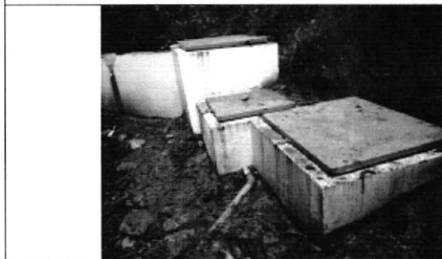
Fotografía 3. Sitio de captación de la JAAP Granda-Caso Quebrada Putcay
