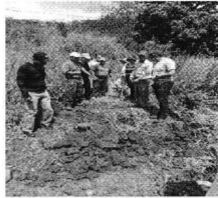
Fotografía 6. Excavación para constatar captación de agua potable en el domicilio del Arq. Edgar Rodas.
