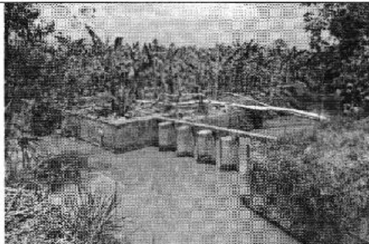
Captación de agua de la antigua Hda. Macybí
