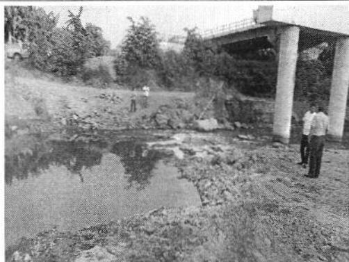
Inspección Obstrucción Río Bulubulu Hidalgo e Hidalgo
