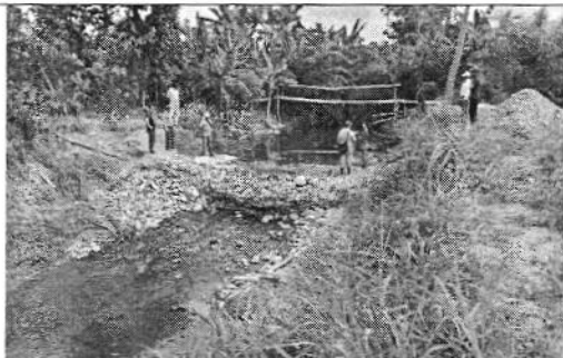
Inspección Obstrucción Estero Vainilla
