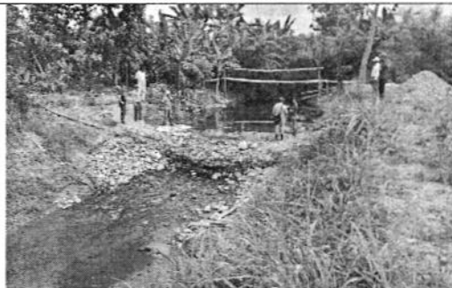
Inspección Obstrucción Estero Vainilla
