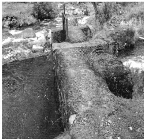
Fotografía 11. Obra de captación del Río Tomebamba (Río Quinoas) en la propiedad Sr. Guido Carrasco.
