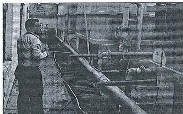
Ilustración 6. Inspección del sistema de tratamiento de agua de la EPMAPAVEN.
