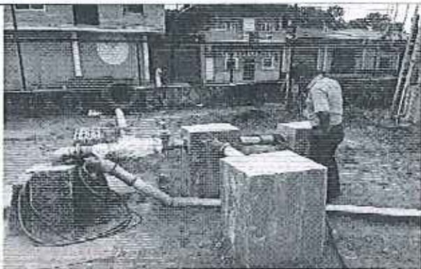
Ilustración 3. Inspección de las fuentes de agua cruda (pozos) del GADM de Urdaneta.
