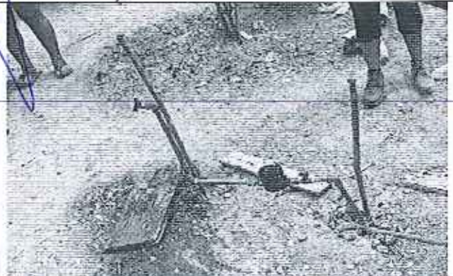
Ilustración 2. Verificación de estado de los micromedidores en la comuna San Marcos.
