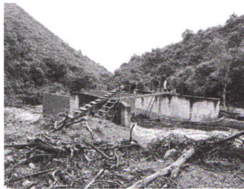
Fotografía 4. Obra de captación de agua para consumo humano.
