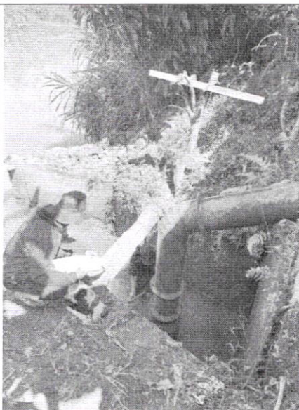
Sistema de bombeo
