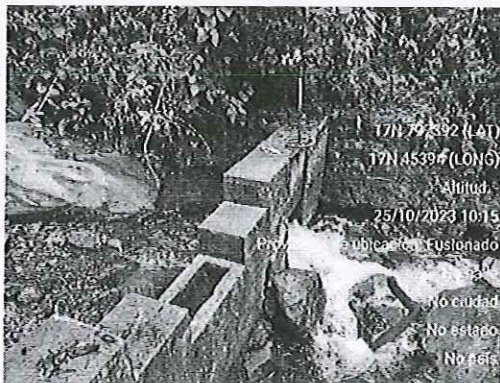
Fotografía 5. Fuente de captación sin funcionamiento.
