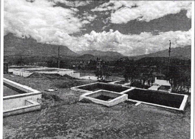
Fotografía 4. Planta de tratamiento de agua cruda
